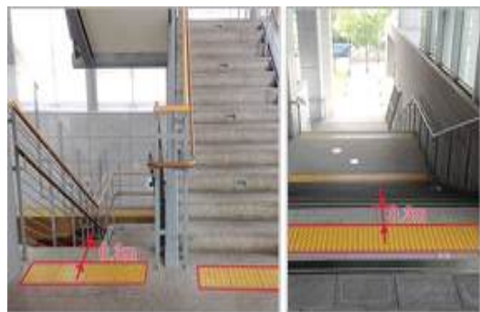
계단의 시작과 끝지점에 점형블록을 규정에 맞게 설치한 사례 사진
